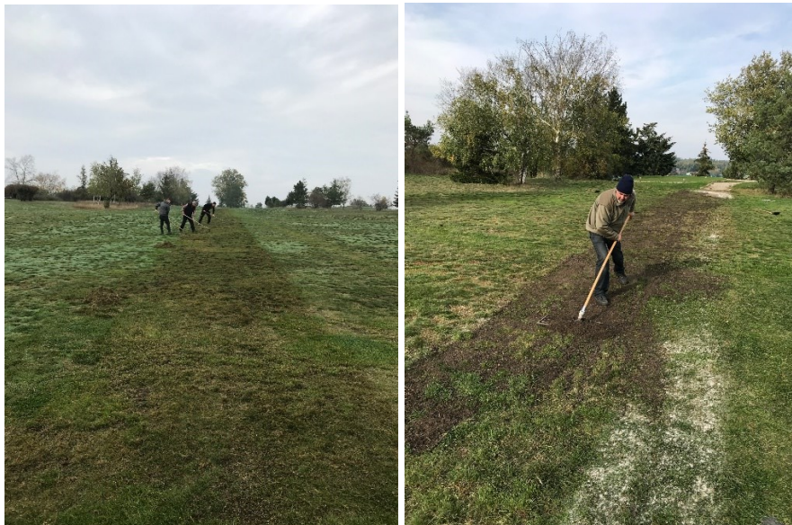
Budování průchodu pro vozíky – vlevo pás po vertikutaci, vpravo srovnání části plochy substrátem
